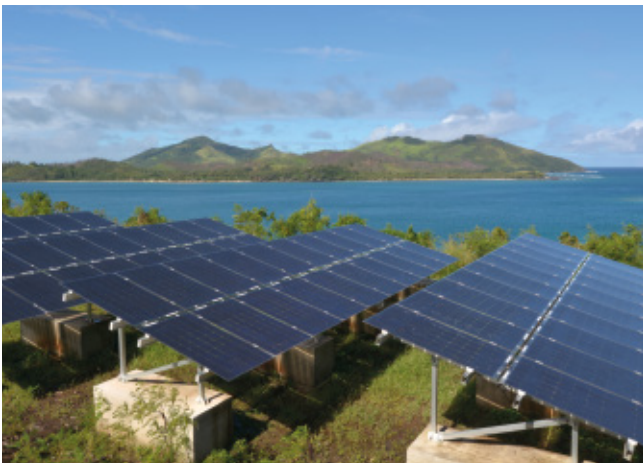
Solar PV modules Fiji.
